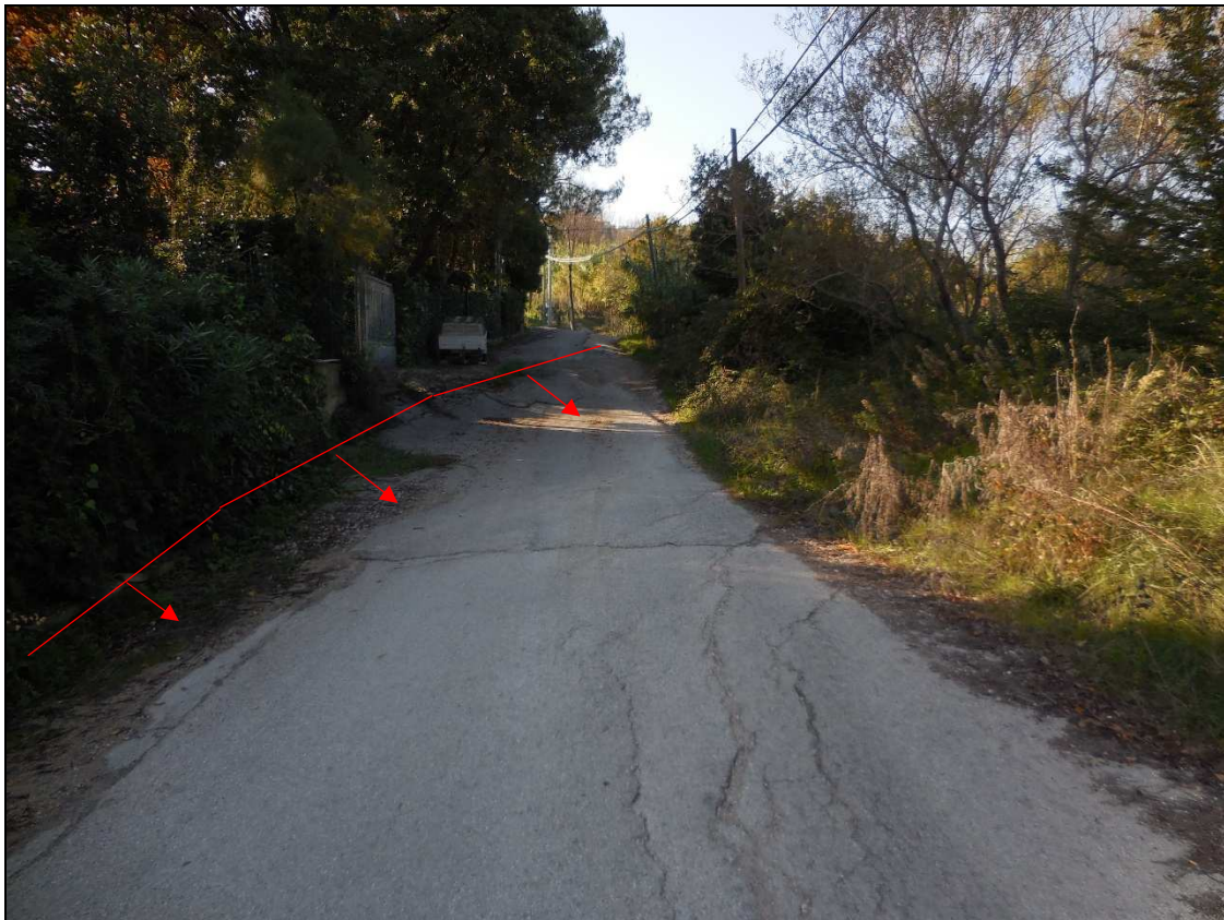
Foto 3. Nicchia di frana in corrispondenza della Strada Comunale
