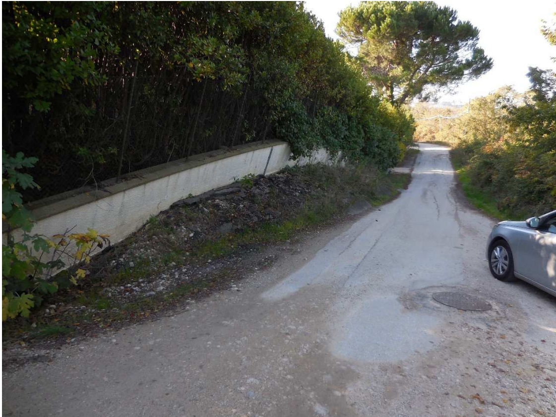
Foto 4. Muro in fase di ribaltamento immediatamente a monte della Strada Comunale.
