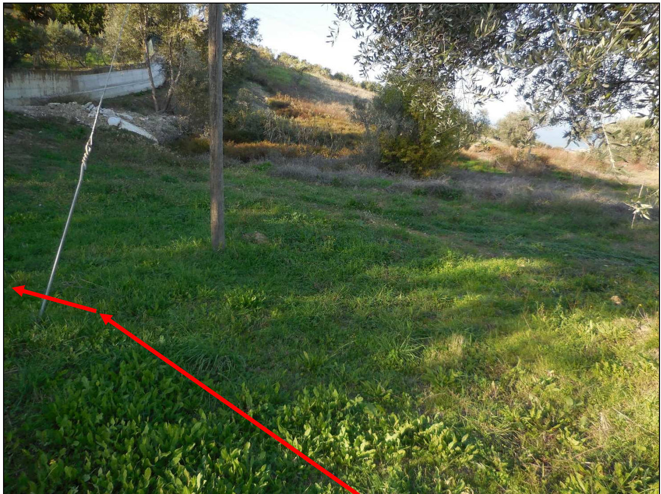
Foto 2. Zona di svuotamento il lenta evoluzione a valle del muro di sostegno. Il tracciato non è direttamente coinvolto dal fenomeno.
